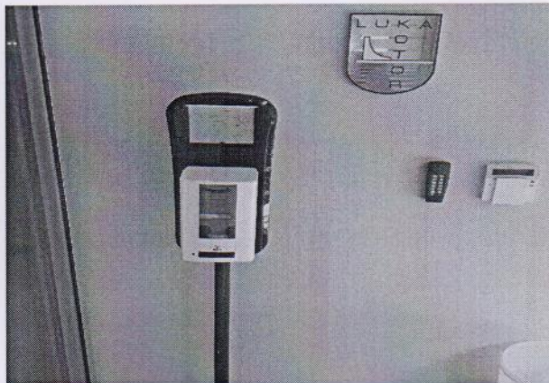
Slika 6 - Automatski bezkontaktni dozator za dezinfekciju (Sense-disinfect) (Pozicija upravna zgrada Luka Kotor)
